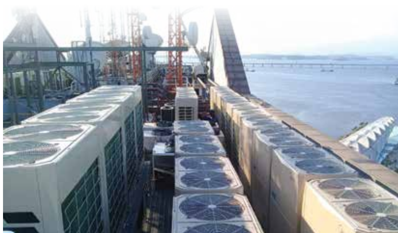
Equipamentos VRF Midea instalados na cobertura do Edifício RB1
